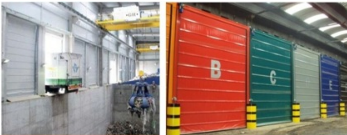
Figura 17 – Recepção dos Orgânicos e Túneis de Compostagem
